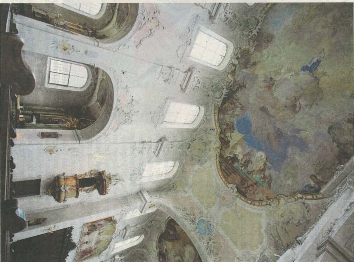
Risse in den Wänden und Decken. Die Innensanierung des Arlesheimer Doms soll im Herbst 2015 abgeschlossen sein. Foto: Henry Muehlenberger
