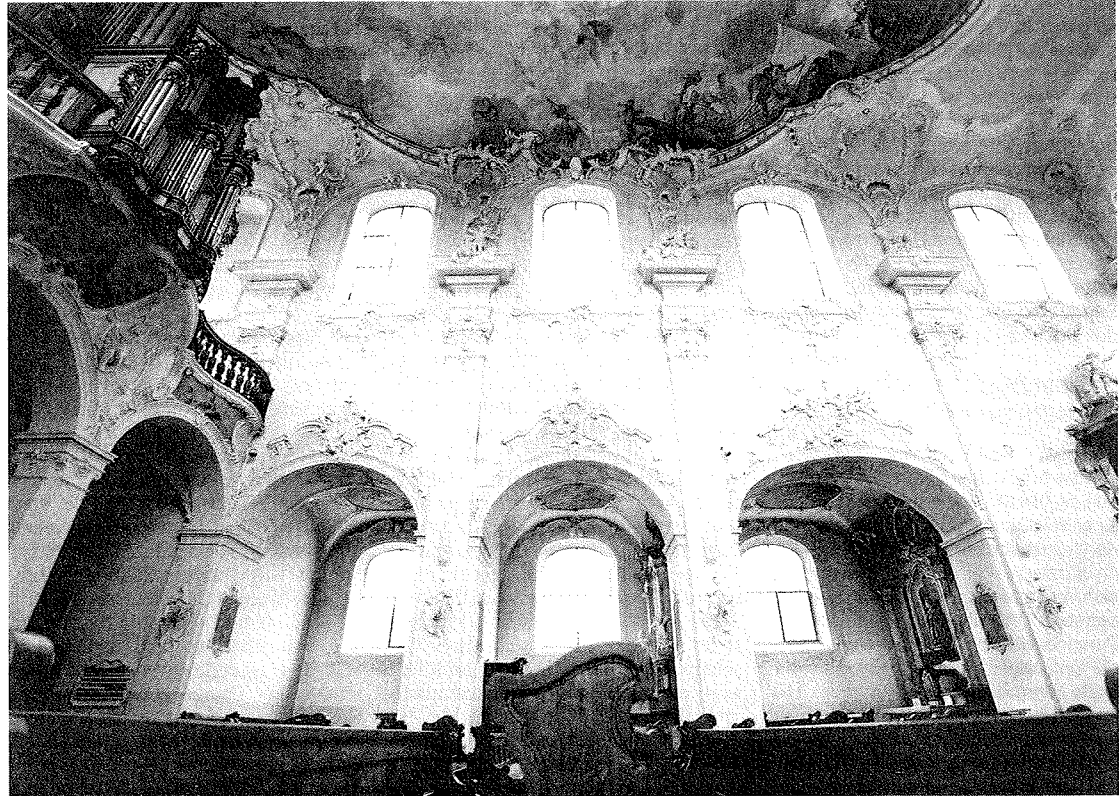
Renovationsbedürftig. Das bedeutende Arllesheimer Denkmal muss restauriert werden. Foto Henry Muchenberger
